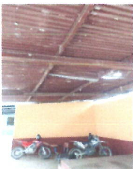
CUBIERTA DE LAMINA SUSTITUCION DE CUBIERTA DE LAMINA EN MAL ESTADO
